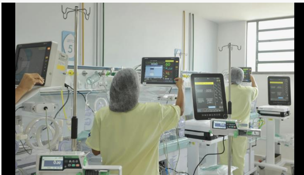
Novas instalações do Hospital Iguassú. Unidade foi inaugurada nesta quarta-feira Divulgação / Rogério Santana / PMNI
